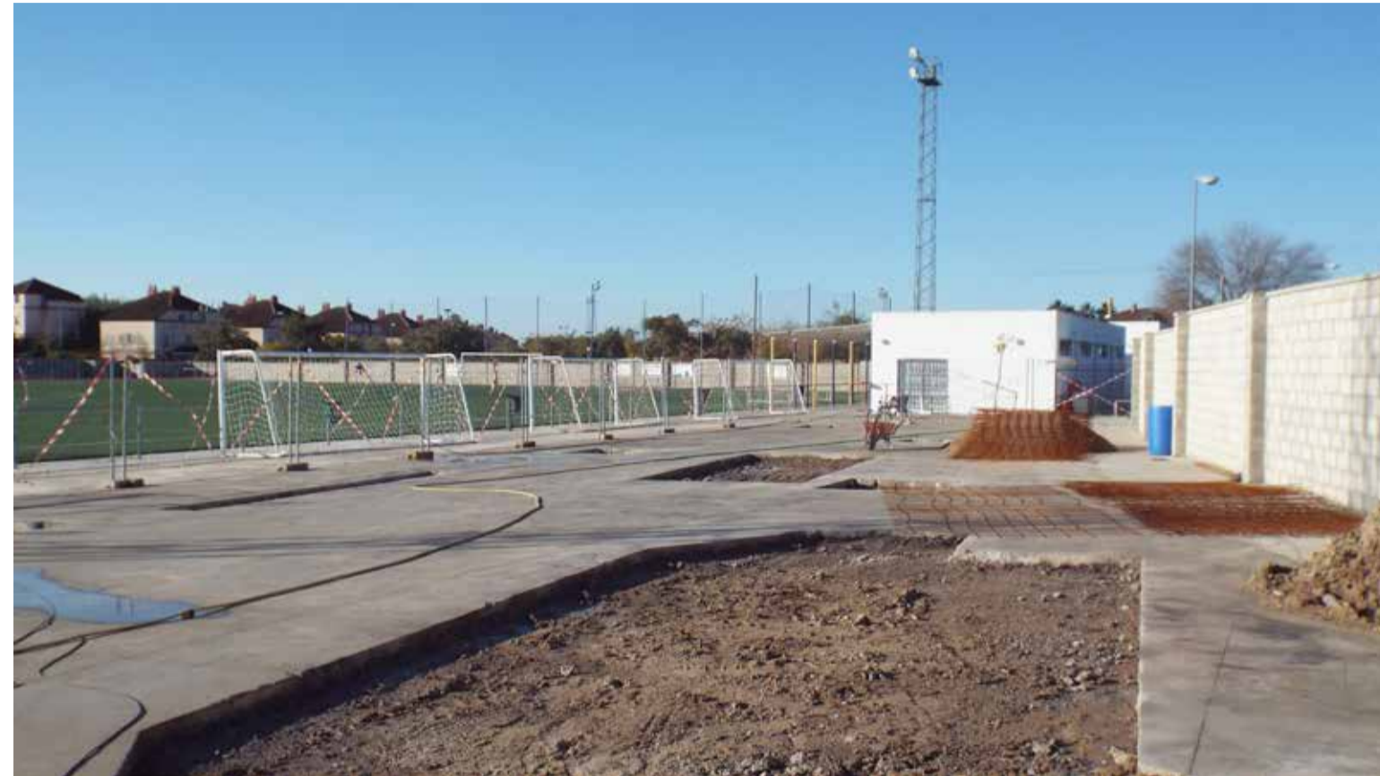
Ya han comenzado las obras de construcción del “skatepark” en el Estadio Nuevo San José.
